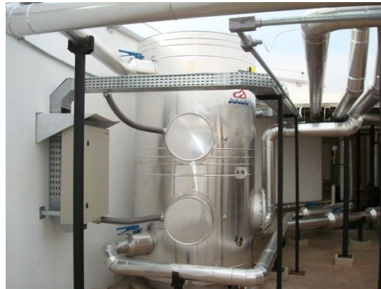
Chiller com recuperação de calor
